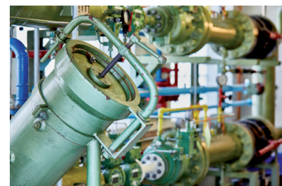
Regelanlage der Stadtwerke für Gas.
